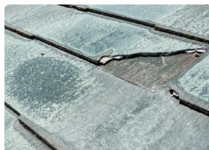
屋根材の割れ
