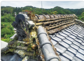
屋根本体の経年劣化
