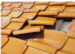
屋根材のズレや浮き
